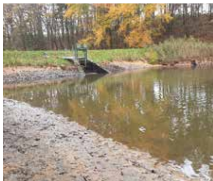
Blick auf den Dammbereich am Tag des Gestängebruchs
